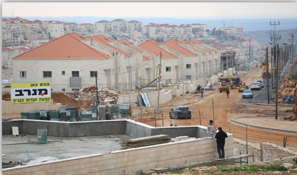
صورة ( 17 ) : توضيح تواصل البناء في مستعمرة "بيتارعليت" في محافظة بيت لحم بتاريخ 2018/12/29
